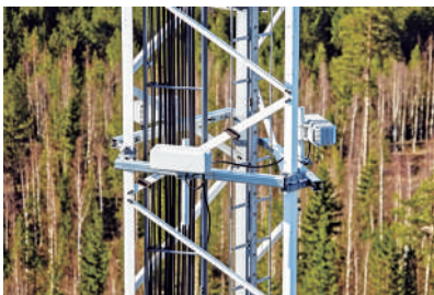
布置在林间铁塔上的新型紧凑型无源传感器。
