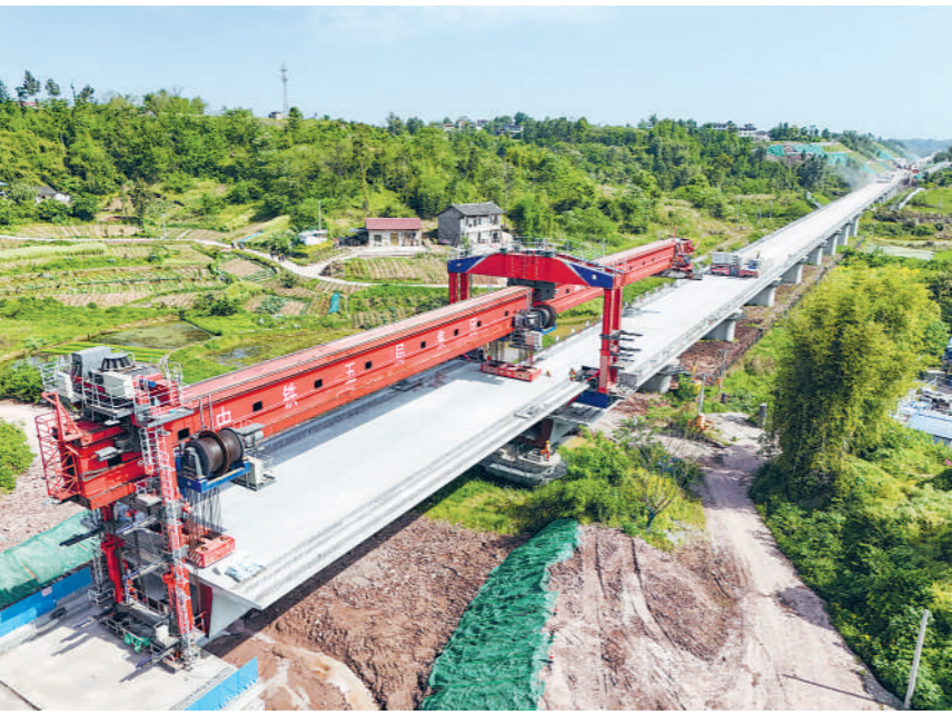
4月17日，西渝高铁双洞特大桥最后一孔箱梁完成架设，标志着全长约115公里的西渝高铁达州至广安段共1520孔箱梁架设完工，为下一步无砟轨道施工和铺轨创造了条件。图为当日在四川省广安市境内拍摄的该特大桥架梁作业现场。
