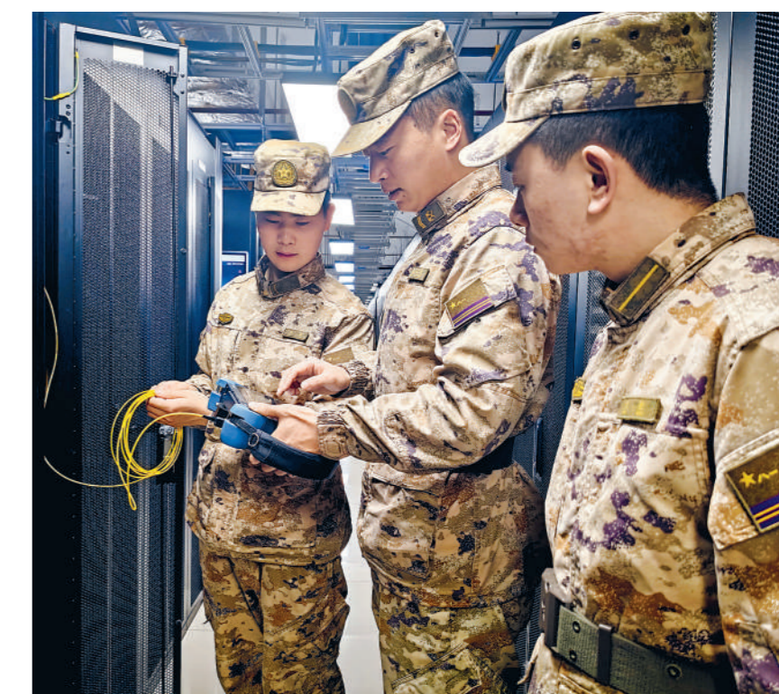
该部官兵巡检机房设备运行状态。
