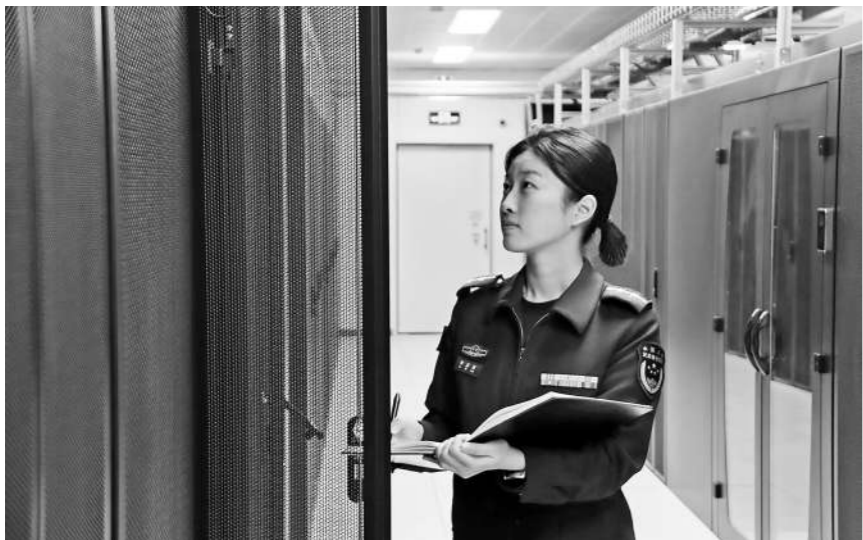
武警工程大学学员邱鑫源正在检查调试相关设备。
