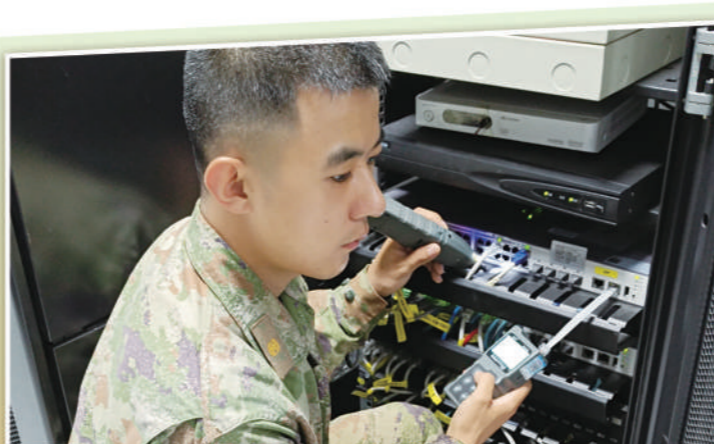
李智一行、爱一行、钻一行。图为他正在机房检查通信线路。魏星摄
