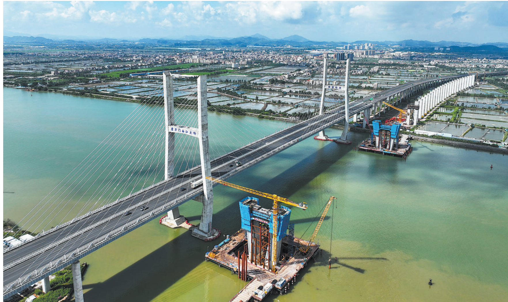
9月1日，深江铁路跨磨刀门水道主桥东主墩（左下）下横梁浇筑完成。深江铁路工程建成后，深圳与江门可实现1小时内通达，深圳与广州南沙自贸片区可实现半小时高铁互联互通。新华社记者 刘大伟摄
