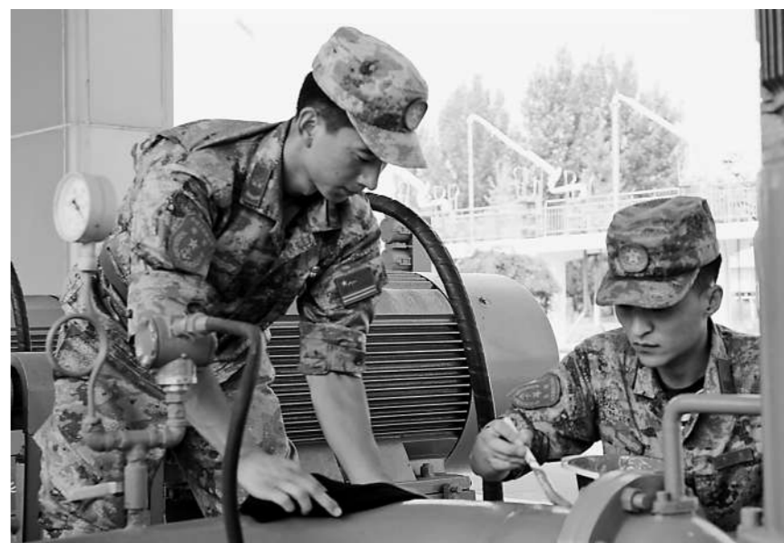
7月下旬,北部战区海军某部结合驻地季节特点开展“设施设备保养月”活动。图为官兵进行油料管线维护。路云摄
