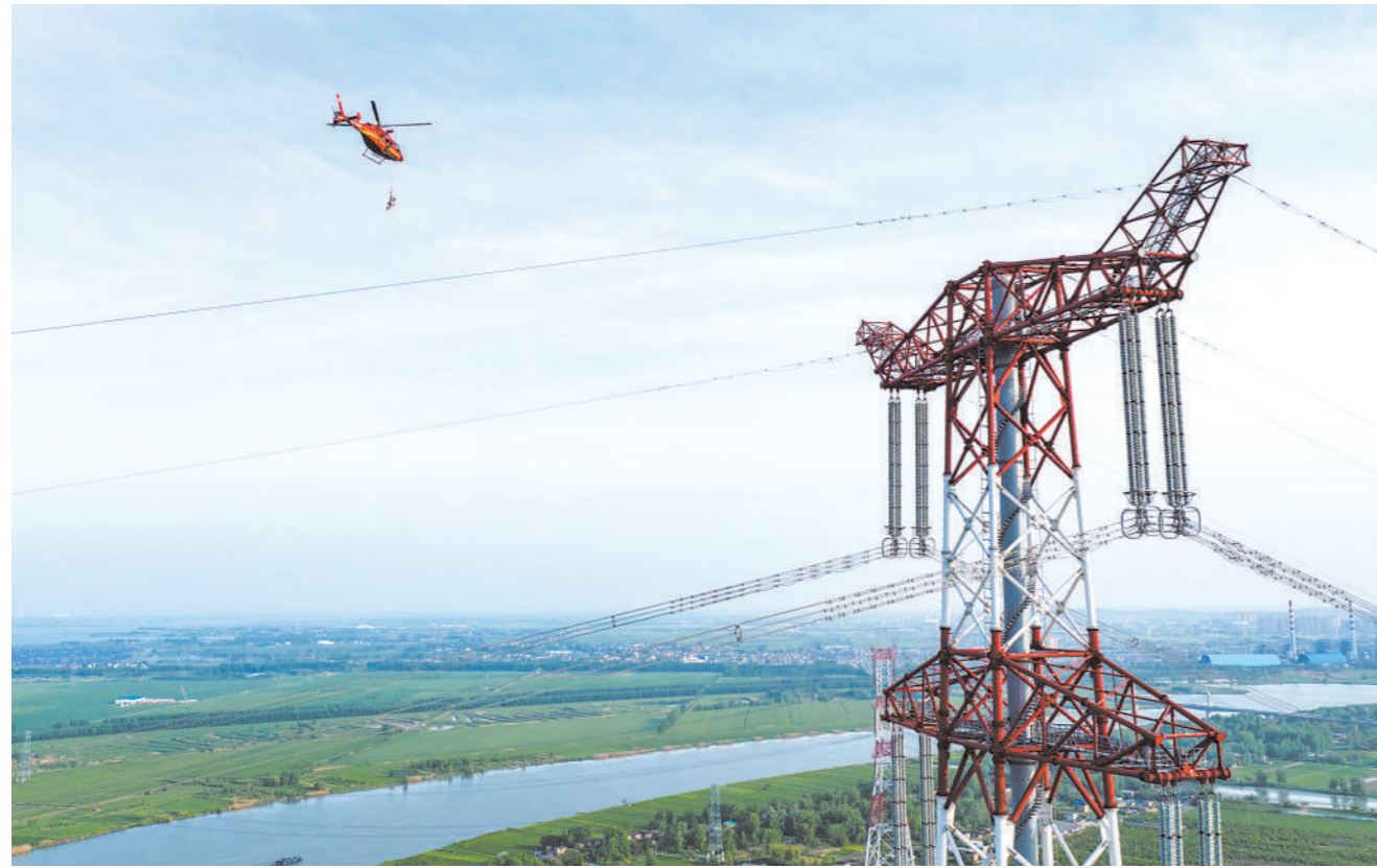
4月18日，在位于安徽省淮南市集集区同村口的淮河边，一架轻型直升机将检修人员吊送至1000千伏特高压淮甯线大河大跨越输电工程开展检修作业，确保迎峰度夏期间华东能源通道稳定安全。
