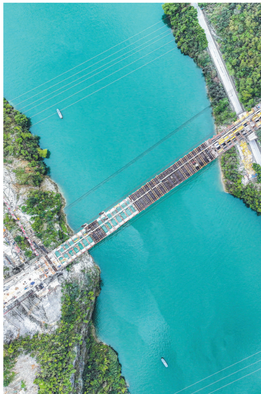
4月8日，渝湘高铁黄草乌江双线大桥重庆岸引桥上部结构顺利实现合龙，目前该桥完成建设进度90%，进入全桥合龙前的最后冲刺阶段。图为当日拍摄的渝湘高铁黄草乌江双线大桥（无人机照片）。新华社记者 唐奕摄
