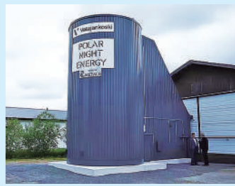
存储沙子的钢制筒仓。
