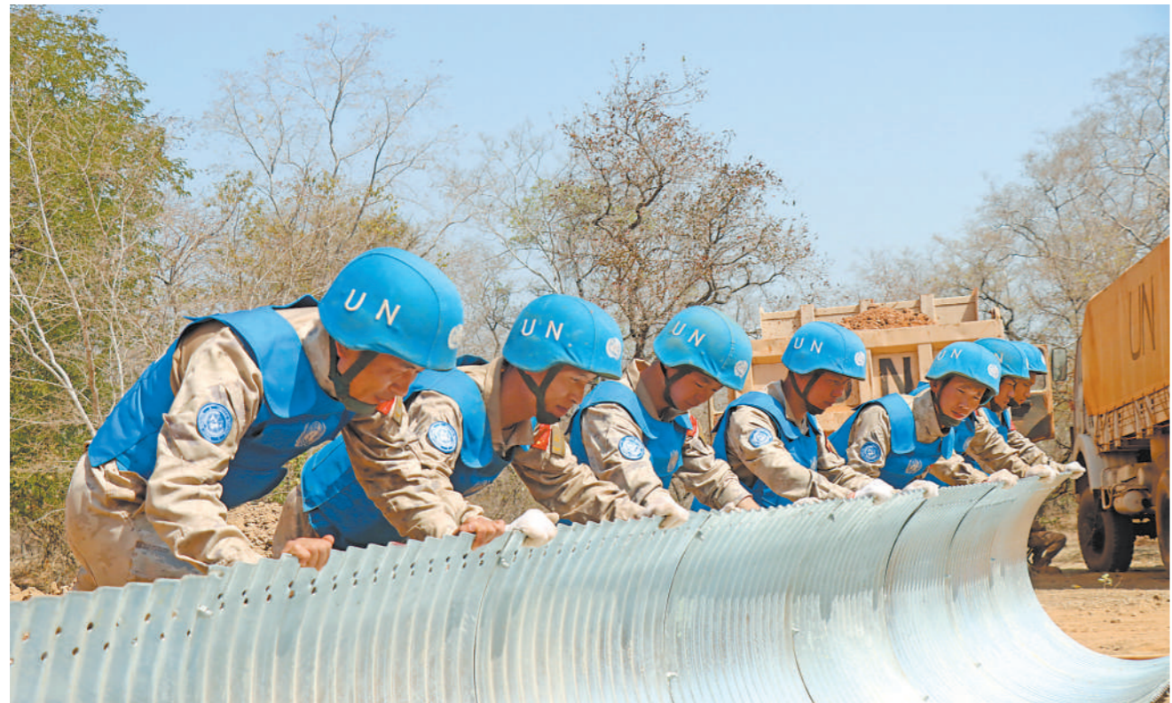
近日,中国第14批赴南苏丹维和工兵分队经过近1个月连续奋战,高标准完成任务区交通主干道——科瓦乔克至阿科普地区段道路修复任务,得到联南苏丹工组的高度评价。图为维和官兵在施工期间铺设涵管。 马 赛 摄
