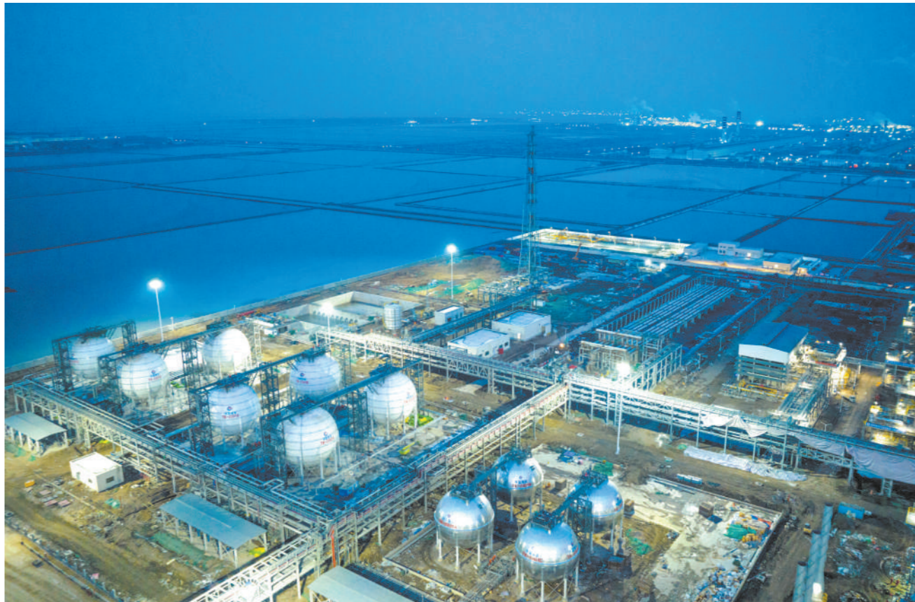
1月12日，山东滨州天然气处理终端工程建设现场吊机林立，重型车辆穿梭，近1300名建设者夜以继日忙碌在施工现场。滨州天然气处理终端工程是渤海油田在建的最大规模天然气终端项目，项目投产后将为我国华北地区提供稳定可靠的绿色清洁能源。图为滨州天然气处理终端工程建设现场(无人机照片)。
