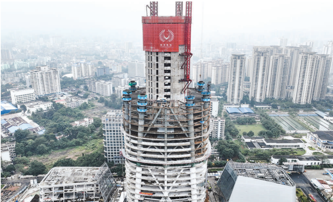
日前,海口市海南中心项目核心筒第18次顶升顺利完成,全力冲刺200米高度。据悉,海南中心总建筑高度达428米,集观光游览、超五星酒店、高级写字楼、精品商业等多功能于一体,项目建成后将成为海南第一高楼。图为12月1日拍摄的施工中的海南中心项目(无人机照片)。
